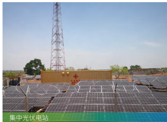
集中光伏电站
