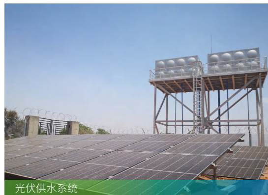
光伏供水系统
